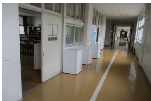
常滑西小学校(設置状況)
