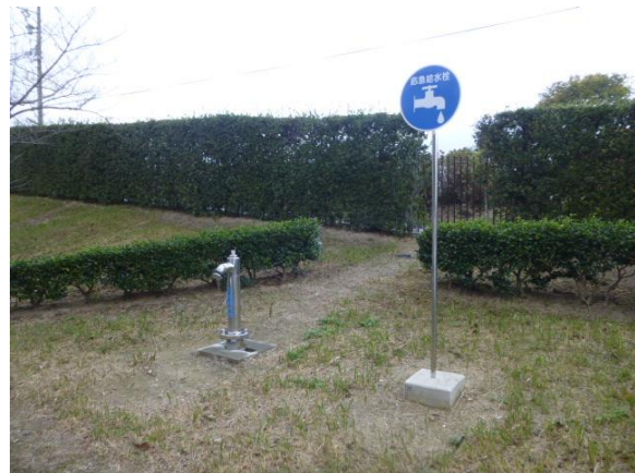
常滑市体育館の応急給水栓（地上式）
