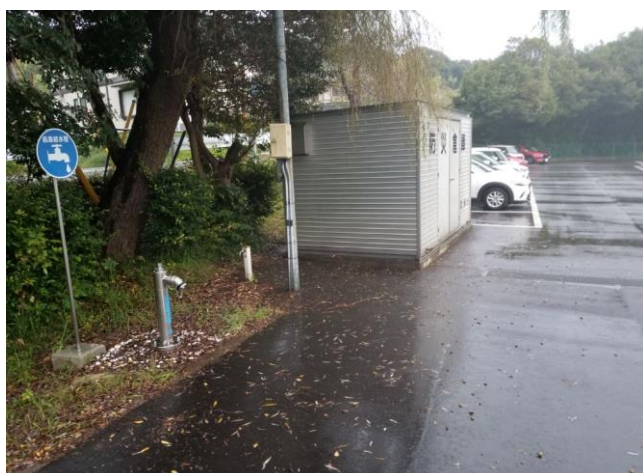
常滑東小学校：応急給水栓の設置状況（地上式）
