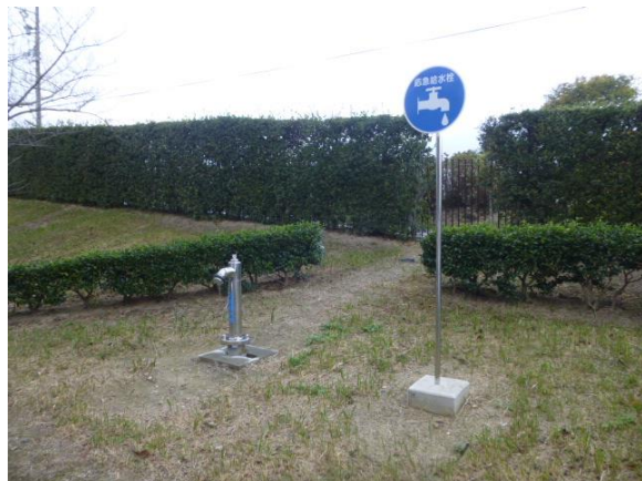
常滑市体育館の応急給水栓（地上式）
