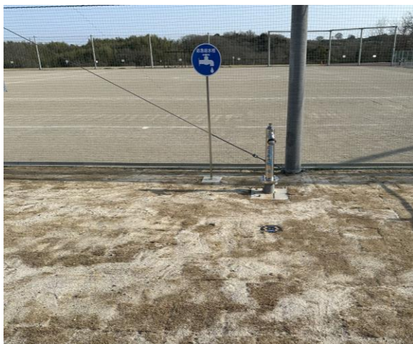
大曾公園の応急給水栓（地上式）
