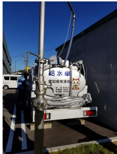
常滑市役所の応急給水栓（地上式・給水車用）
