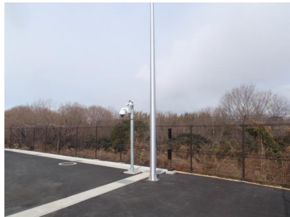
監視カメラ（久米配水場）
