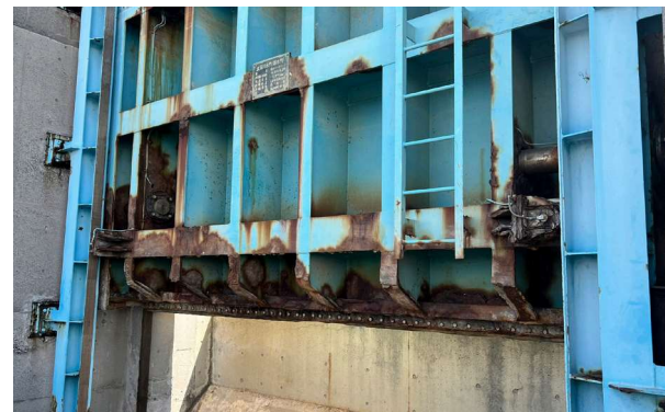
さびのある矢田川樋門
