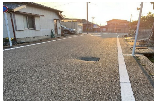
道路陥没の状況
