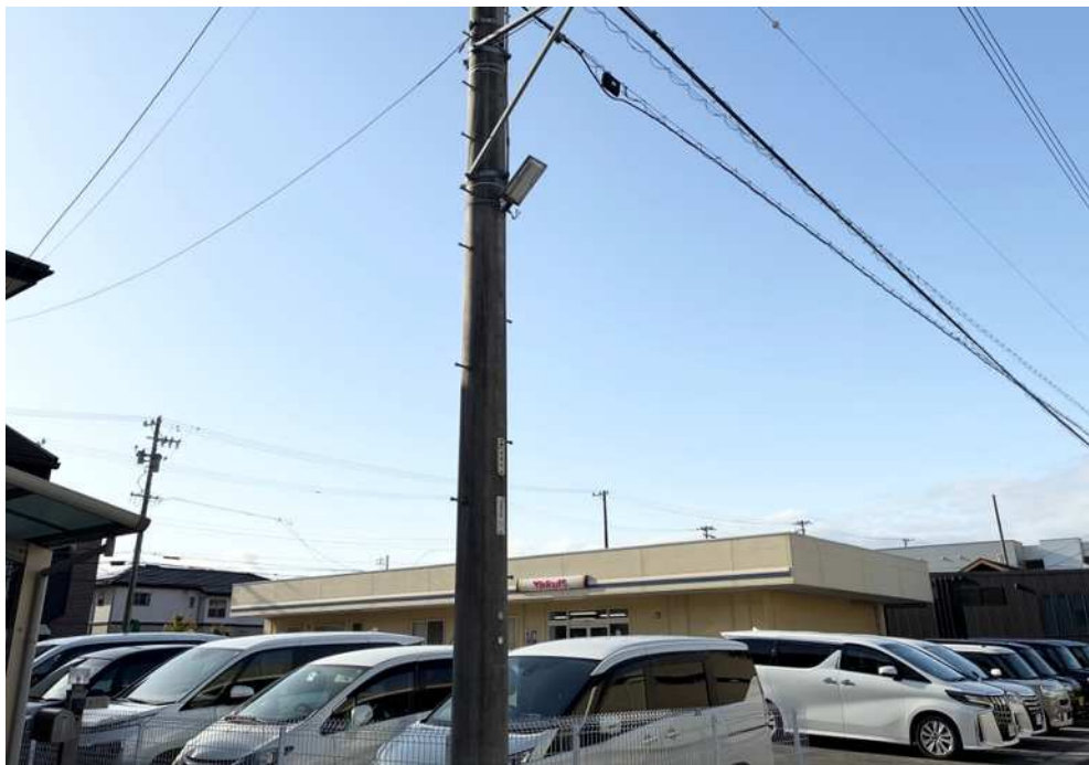
電柱に設置されている防犯灯
