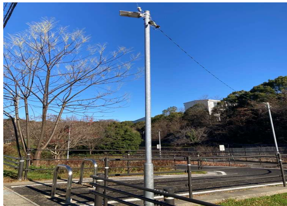
専用柱に設置されている防犯灯 (専用柱も市に移管します)
