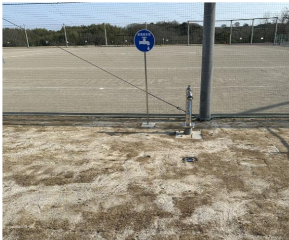
大曾公園の応急給水栓（地上式）
