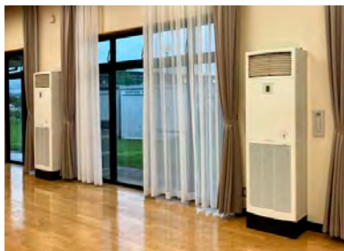
更新した小倉公会堂のエアコン
