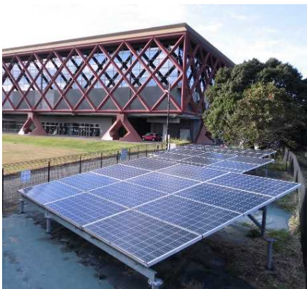
▲太陽光発電施設 (市体育館)
