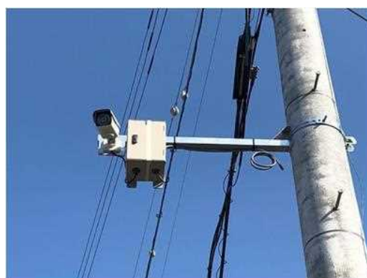
▲設置した防犯カメラ
