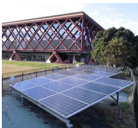
▲太陽光発電施設 (市体育館)
