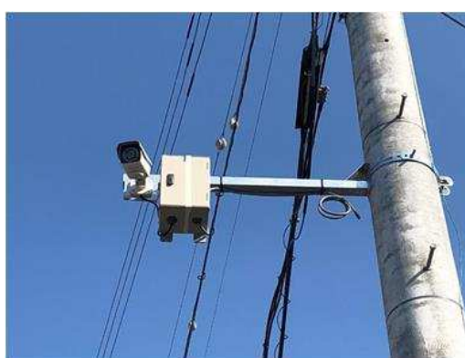
▲設置した防犯カメラ
