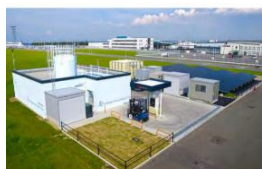
貨物地区水素充填所ステーション
