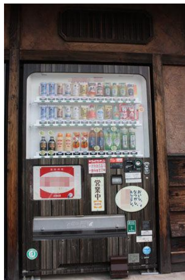
建物の壁の中に設置した事例
