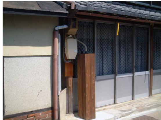
プロパンガスボンベを木板で囲った事例
