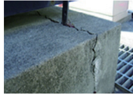
基礎のクラック、支柱と根巻 きとの隙間、支柱のぐらつき
