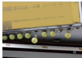
照明装置の取付部の破損、 変形、さび、漏水
