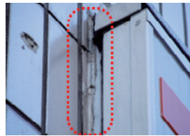
溶接部の劣化、コーキングの 劣化等
