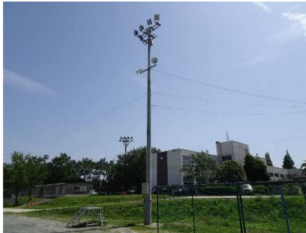
青海中学校夜間照明施設
