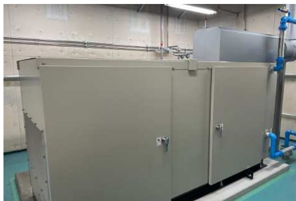
非常用発電機
