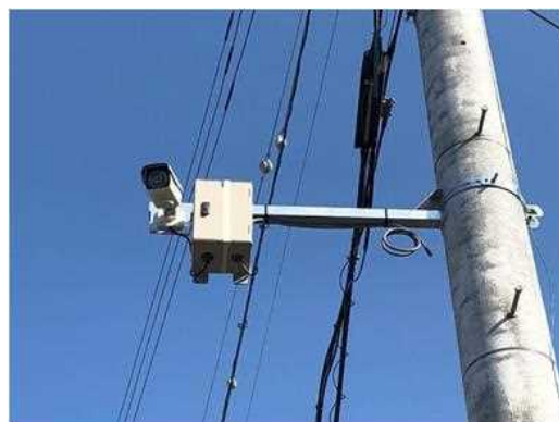
▲設置した防犯カメラ
