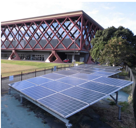
▲太陽光発電施設 (市体育館)
